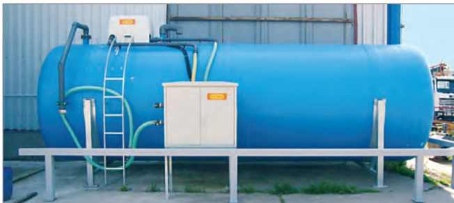
komplett installierte Feuchtsalzanlage inkl. Pumpeneinheit
